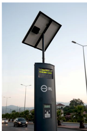
Figura 21 – Pannel de informação em tempo real da Rodoviária de Lisboa, alimentado a energia solar, com comando de informação sonora para cidadãos invisuais
